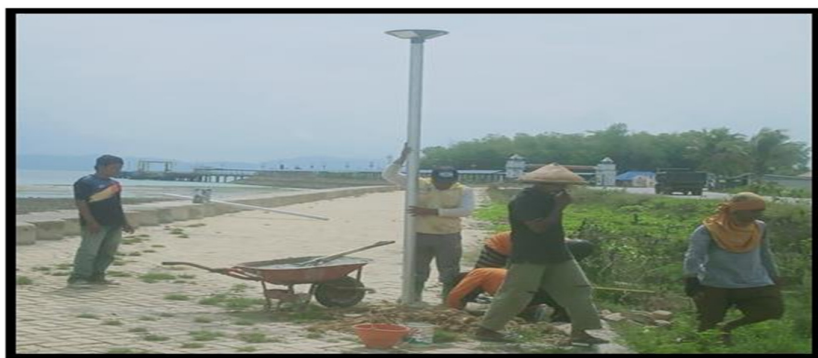
Gambar 3.12. Kegiatan Pemeliharaan Taman Kota, lampu jalan dan pembangunan lampu jalan dan taman
